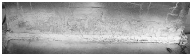
Rys. 6. Złącze próbne 3FW. Widoczne nierówne lico spoiny
