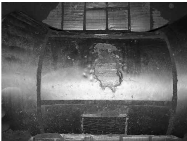
Rys. 3. Zużyta okładzina po 1200 h pracy Fig. 3. Lining worn after 1200 hours of operation
