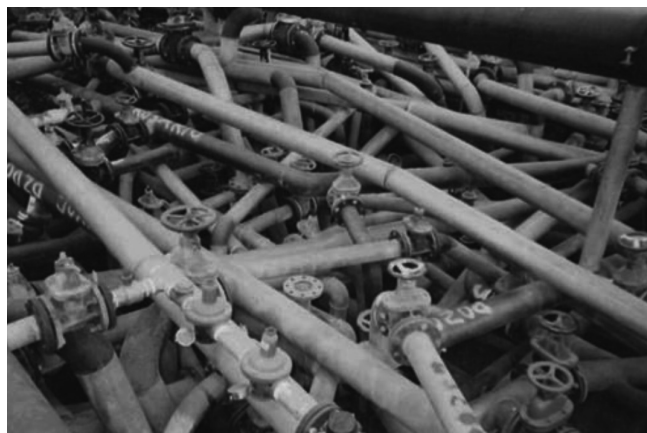
Rys. 4. Przykład niewłaściwie zaprojektowanej instalacji wymagającej uproszczenia
