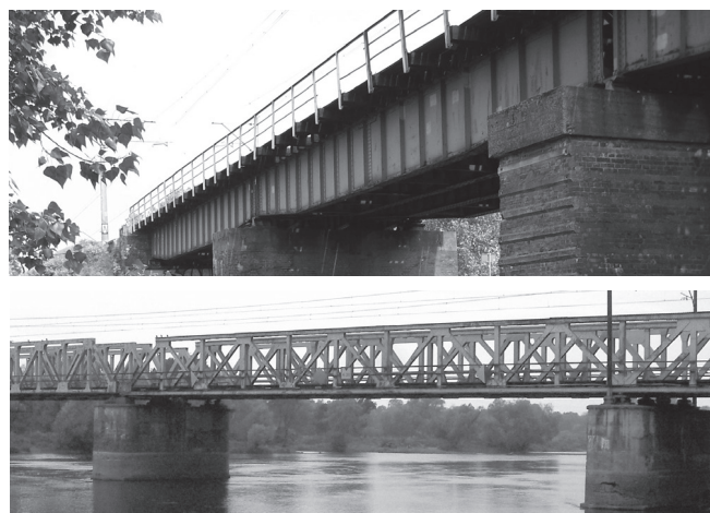
Rys. 1. Mosty kolejowe o zróżnicowanych gatunkach stali: a) most z roku 1873 na linii nr 353, nad Zbiornikiem Pakoskim koło miejscowości Janikowo [4], b) most z roku 1875 na linii nr 273, nad Wartą w Kostrzynie nad Odrą [5]
